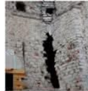
Fot.31 Uszkodzenie muru przy pionowym tunelu schodów spiralnych
