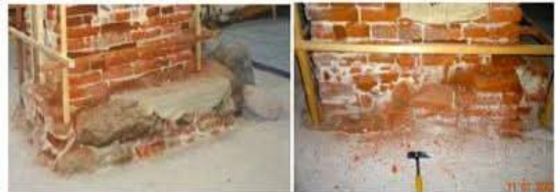
Fot.30 Uszkodzona podstawa filara Nr2 ....
