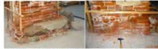
Fot.30 Uszkodzenia podstawa filara Nr2 ..... i filara Nr3
